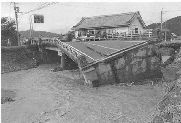
水流で崩壊した前山川と国道175号の合流点にある八日市橋＝市島町上竹田で
